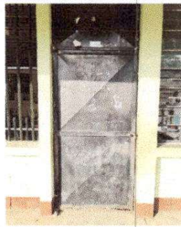
FOTO 2: Sustrucción de puerta
