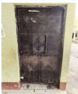
FOTO 1: Sustrucción de puerta
